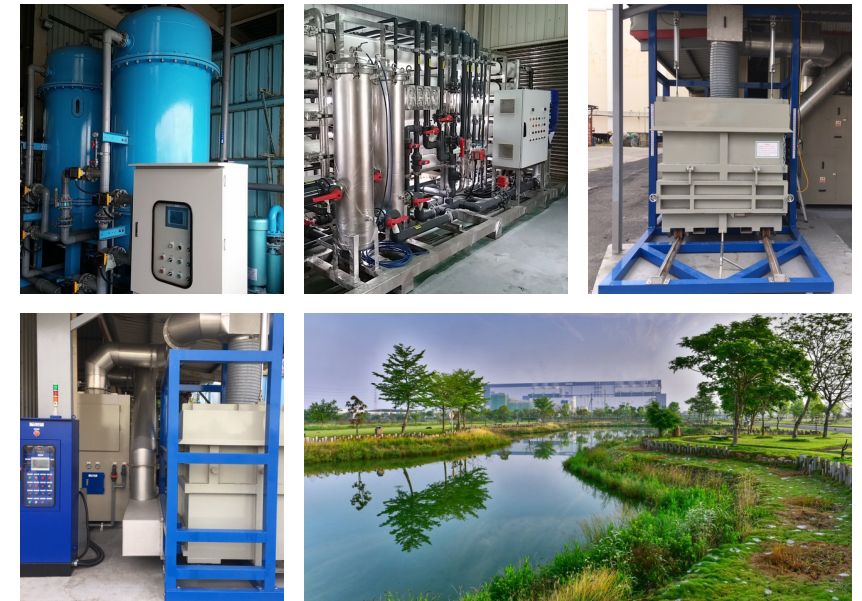
1 纖維過濾系統 2. RO-1 逆滲透系統 3. 污泥乾燥設備 4. 污泥乾燥設備 5. 川益廠區景觀池
